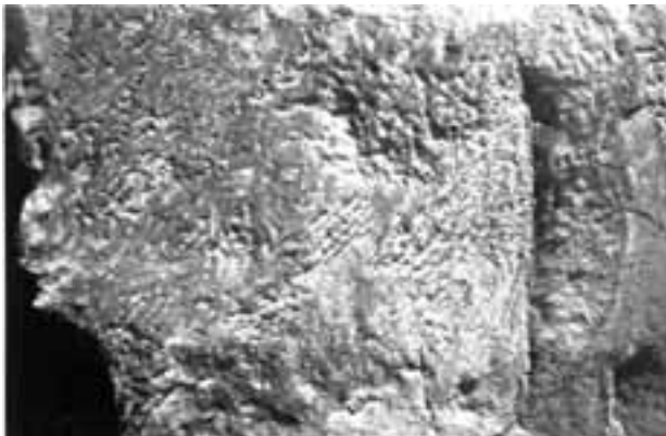
Ein Ausbruch eines Segments, wo der Trennschneider nicht in der Ebene blieb.
