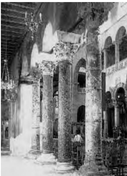
Die Eisenringe halten die Kolonnen zusammen und „zeugen“ von einem sehr hohen Alter. In Wirklichkeit weisen sie nur auf die Feuerbrandauswirkungen aus dem Jahr 1917.
