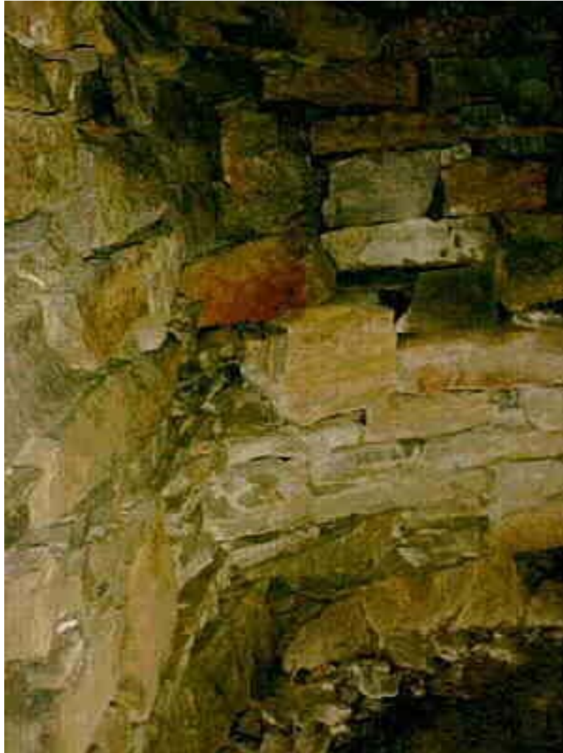
Die Knickecke. Der Gang dieser Anlage beschreibt hier einen rechtwinkligen Knick (Foto: (c) Geise)
