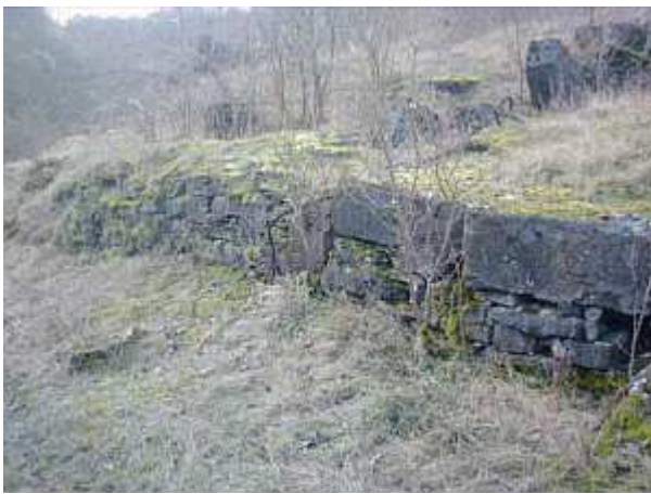
Teile der ehemaligen Umfassungs- oder Stützmauer um den Grabhügel mit dem Knickgang.
