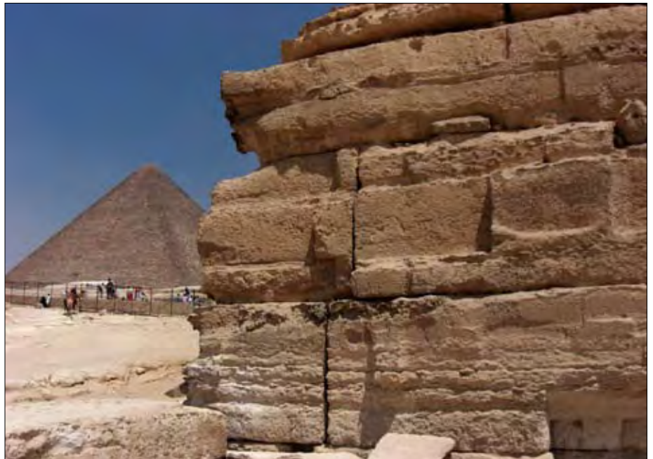
Die Sandstein-Außenverkleidung weist starke Erosionserscheinungen durch Wassereinfluss auf.
