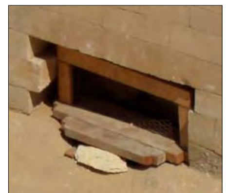
Diese Öffnung führt zu einem verschütteten Schacht.
