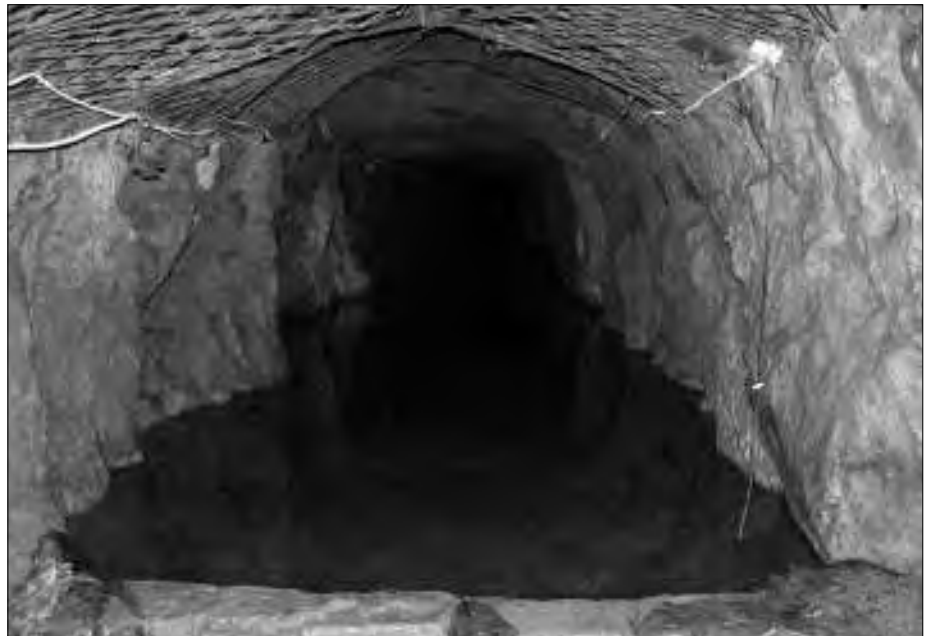
Bild 12: Mit Wasser vollgelaufener Stollen.
