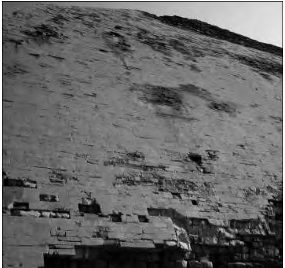
Die „Knickpyramide“ von Dahshur: An den Beschädigungen der Außenverkleidungen sieht man noch heute, wo das durch die Flutwelle in die Pyramide eingedrungene Wasser wieder abgeflossen ist.
