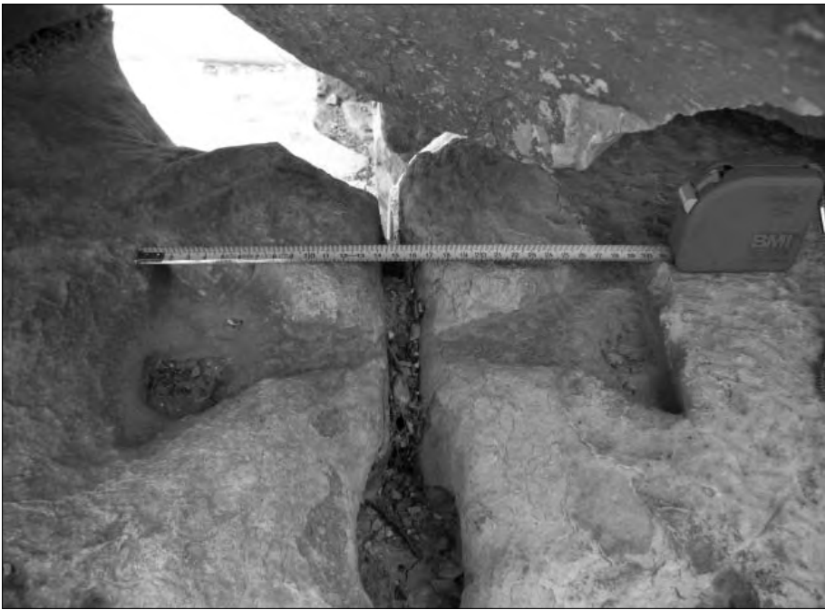
Abb. 34 - Diese Klammerform maß einst ca. 28 cm, wobei der Spalt mit einkalkuliert worden ist. Das Drumherum sieht meines Erachtens ziemlich verschlissen aus für ein Alter von ca. 2.500 Jahren. Man vergleiche mit entsprechenden Detailaufnahmen an den Gizeh-Pyramiden, welche noch mindestens 2.000 Jahre älter sein sollen!
