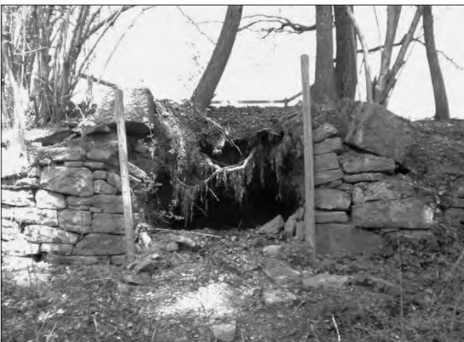
Abb. 5: Eingebrochenes Wengerthäuschen (Zaisenhausen)
