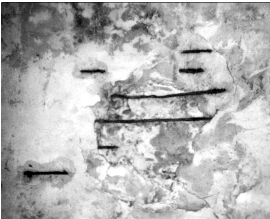
Dokument 22: Fotografie der Öffnung 4 in der Decke des Waschraums.
