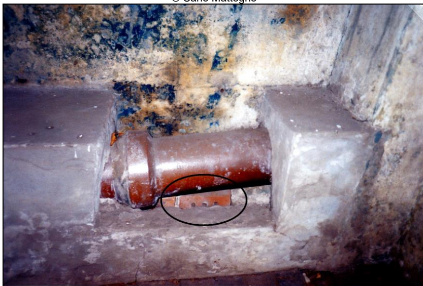
Foto 8: Entlausungskammer in Stutthof, Inneres, Westwand; gusseisernes Verbindungsrohr zum außerhalb der Gaskammer angebrachten Ofen, der zum Erhitzen der Luft diente. Ursprünglich war das Rohr von einem Mauerwerk umgeben, das dem auf dem Foto erkennbaren entspricht, jedoch aus durchlöchernten Backsteinen bestand. Einer dieser Ziegel ist noch heute unten hinter dem Rohr sichtbar (Kreis). © Carlo Mattogno
