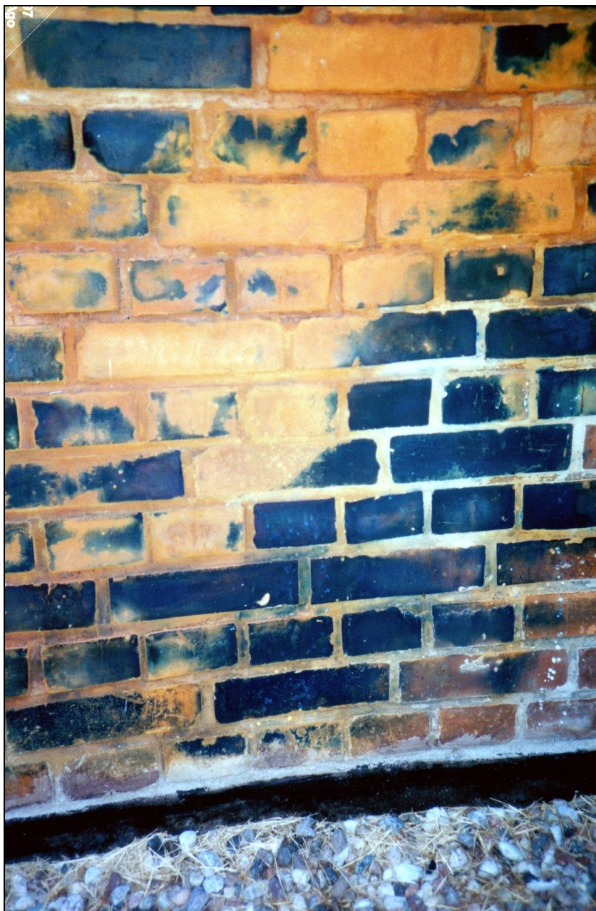
Foto 16: Entlausungskammer in Stutthof, Ostseite, außen. Auf den Ziegeln sieht man die typische Blaufärbung durch Eisenzyanide. © Carlo Mattogno
