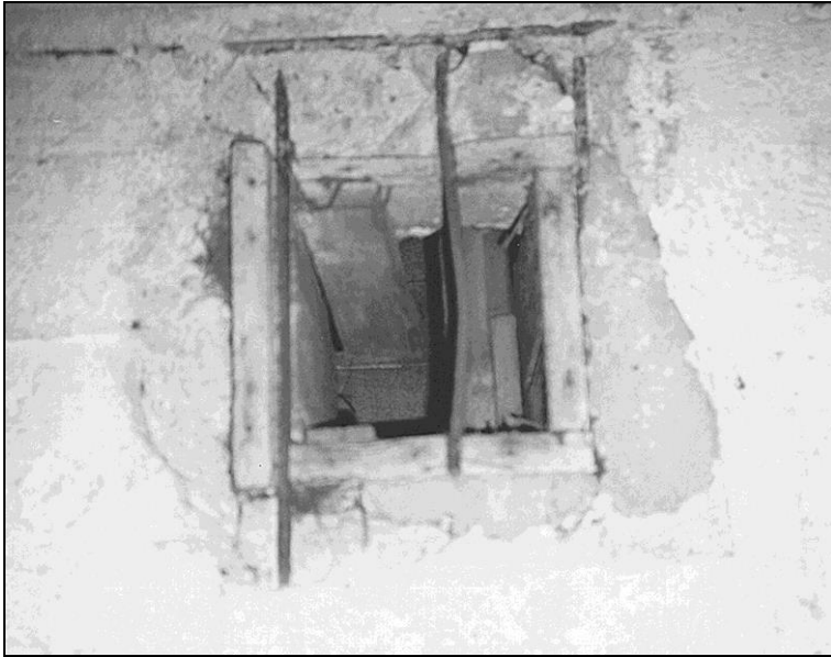
Fotografie XI: Entwesungsanlage bei der Baracke 41, Kammer I, Öffnung in der Decke. (© C. Mattogno.)
