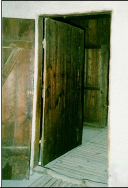
Fotografie XVII: Baracke 41, Gaskammer, Nordtür. Der innere Teil der Türe weist die typischen Flecken auf, die man auch auf der Außenwand der Südtüre (Fotografie XVIa) findet; am Türrahmen fehlen Haken für die Verschlusshebel, im Gegensatz zum Türgestell der Südtür (Fotografie XVI.) (© C. Mattogno.)
